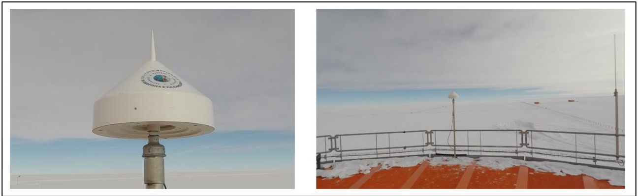
Figura 3 - Nuova antenna e suo posizionamento sul tetto della torre quieta per le stazioni DMC0 e DMC0P (A. Salvati ©PNRA)
