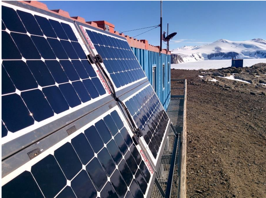
Figura 3 - Pannelli solari presso OASI
