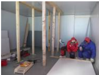
Shelter PHYSIQUE: Doublage de l'isolation des 2 unités en place fin CE09809
