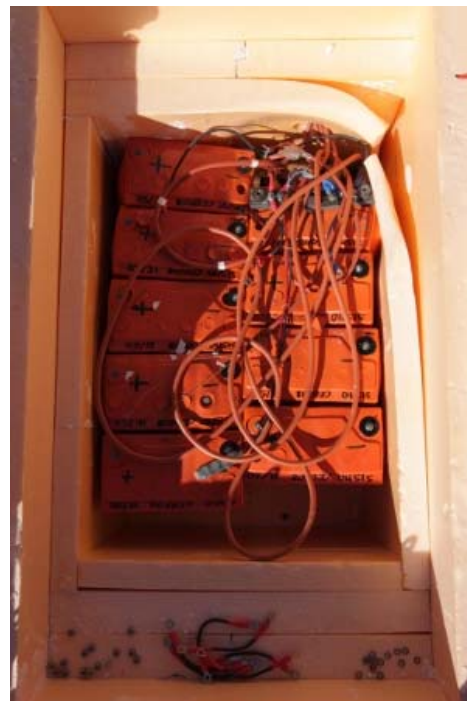
Etat des batteries après surchauffe
