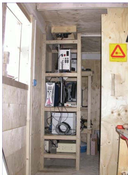
Fig. 2.10 - Installazione Lidar all'interno del Lab. CARO
