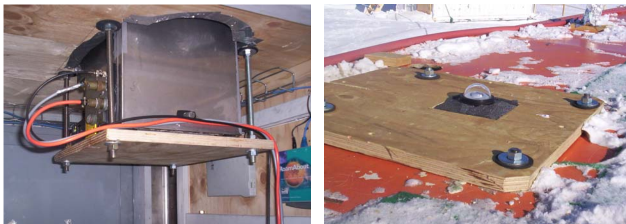
Fig 2.5 - Particolari dell'installazione del UVRAD nello shelter CARO
