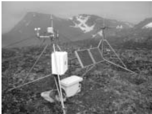
Foto 5.3.1: Stazione di monitoraggio permafrost
