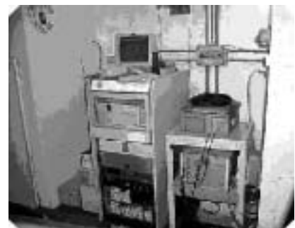
LARC - Strumentazione periferica
